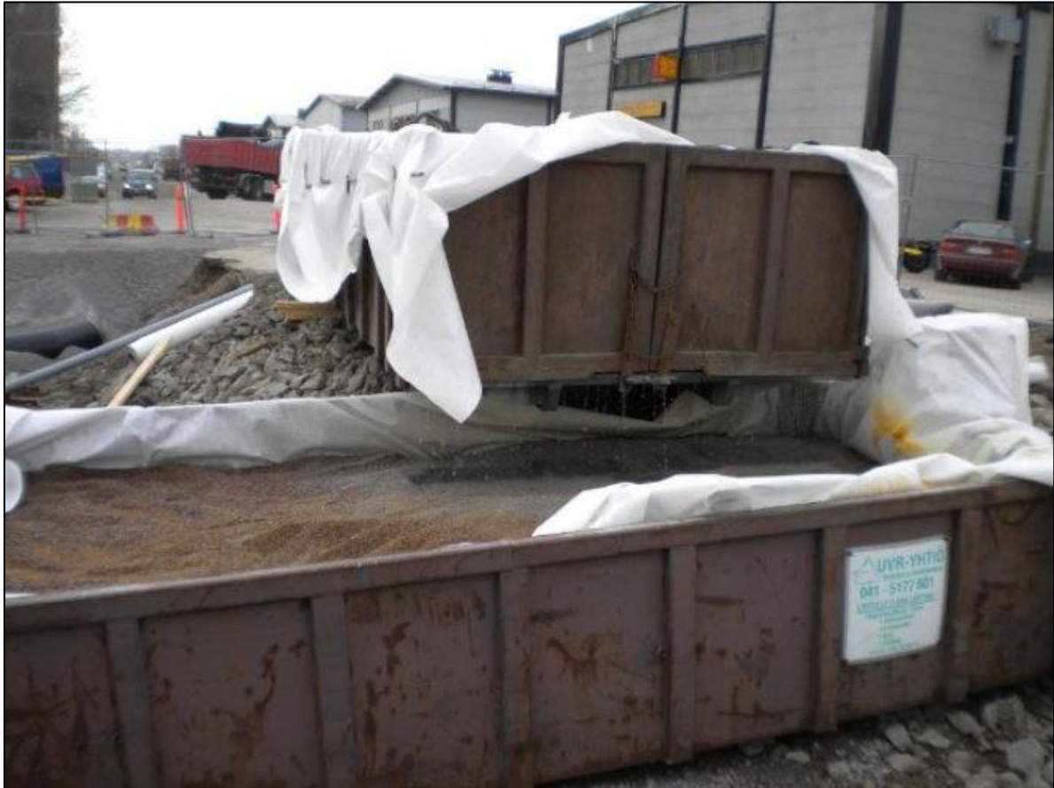
Kuva 5. Esimerkkikuva vaihtolavan sisään rakennetusta suodattimesta. 4
